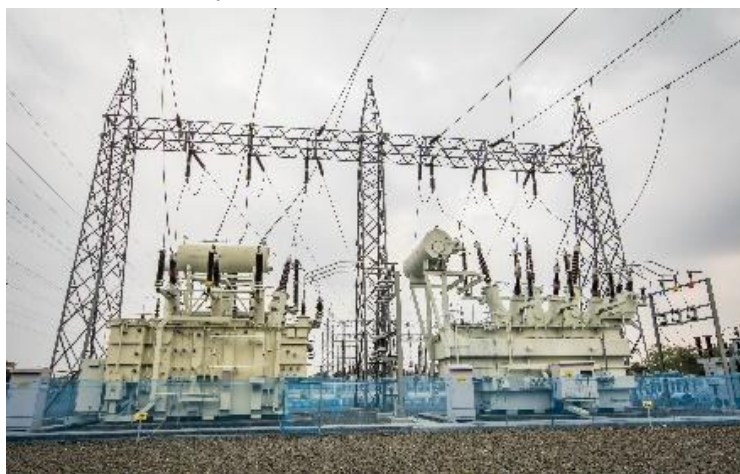
รูปที่ 2 หม้อแปลงไฟฟ้า 230kV
